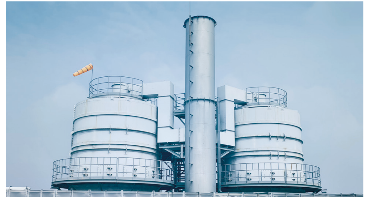
公司增设大气设施 RTO 设备，提升废气处理效率，保证达标排放
