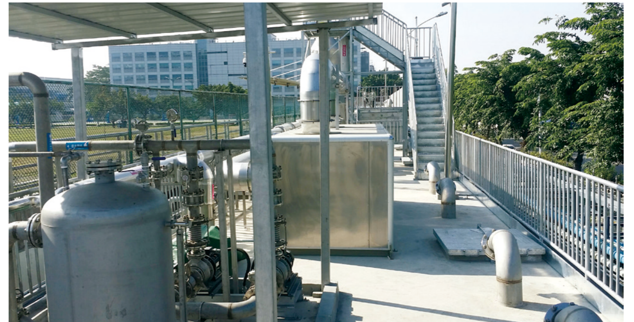
食堂污水站构筑
